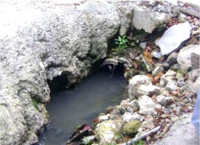
Imagen 101. Sistema pluvial colapsado
