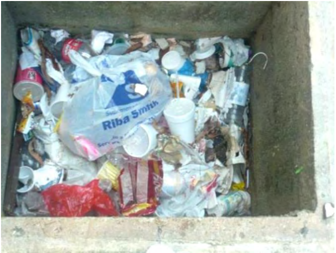
Imagen 102. Sistema pluvial obstruido
