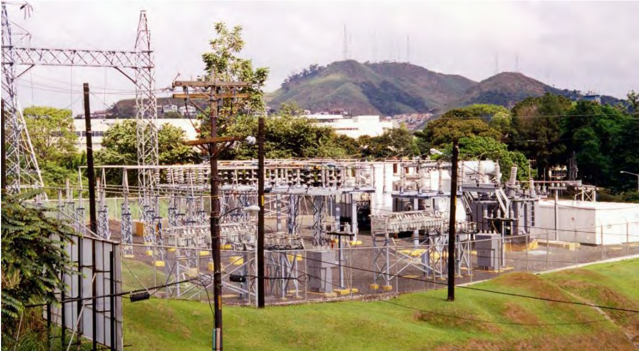
Imagen 122. Subestación eléctrica de Santa María propiedad de ENSA.
