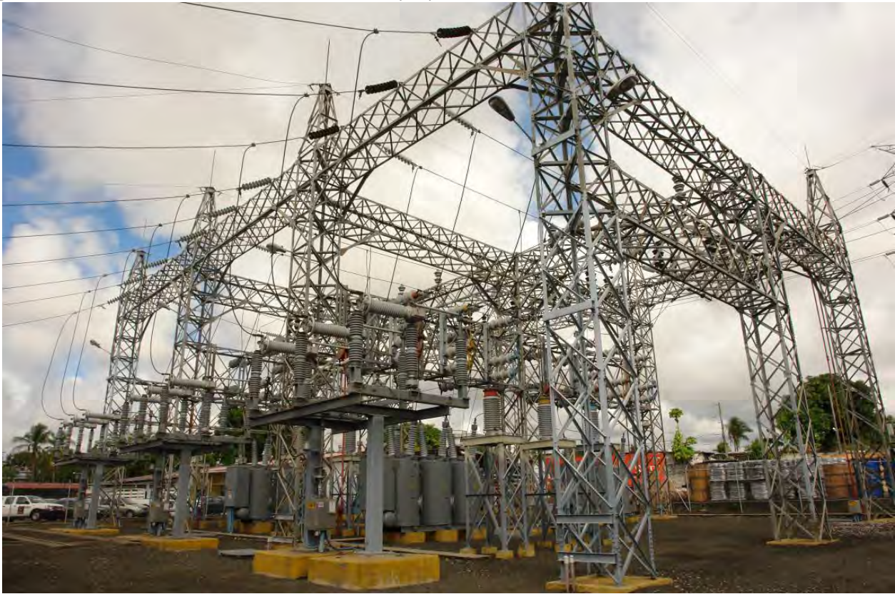
Imagen 123. Subestación eléctrica de Cerro Viento propiedad de ENSA
