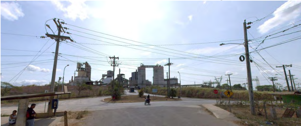
Imagen 127. Tendido eléctrico aéreo en el área de Calzada Larga.
