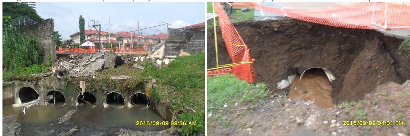
Imagen 152. Inundaciones por colapso y deficiencia de la red de drenaje pluvial en Condado del Rey
