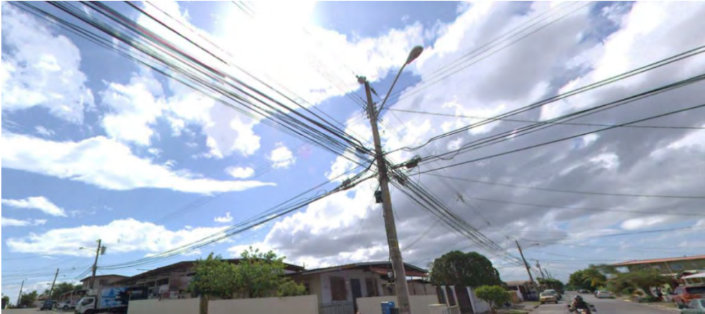
Imagen 128. Tendido eléctrico aéreo en el área de Don Bosco.
